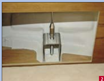
Los tirantes interiores de los obenques están fijados a la estructura primaria del barco.
