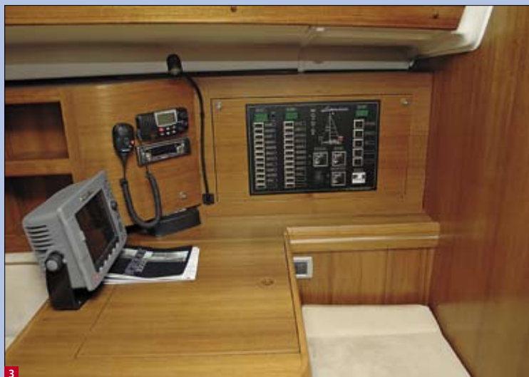
Desde la mesa de cartas tendremos a mano todo el cuadro eléctrico, los equipos de navegación electrónicos y la VHF.
